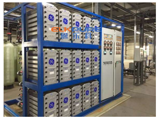
某大型半导体企业 30 台 GE E-CELL 3X 维修现场
